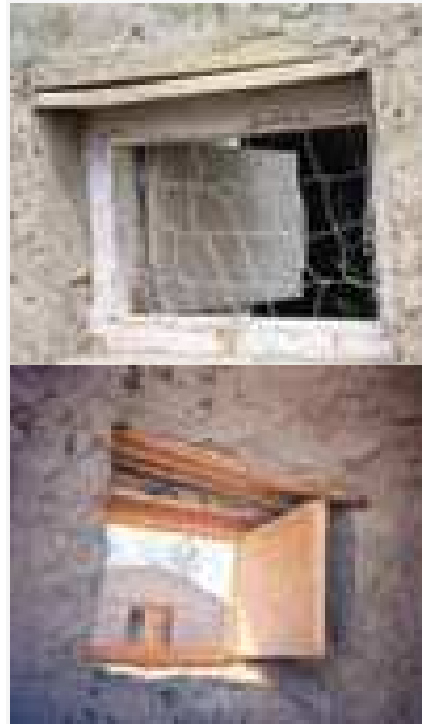
Figuras 53 y 54: vistas interiores y exteriores de la parte instalada del obturador con una malla de gallinero exterior
