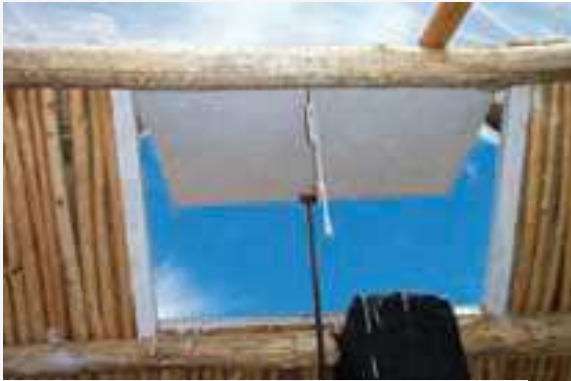
Figura 68: Vista interior de la persiana entreabierto techo
