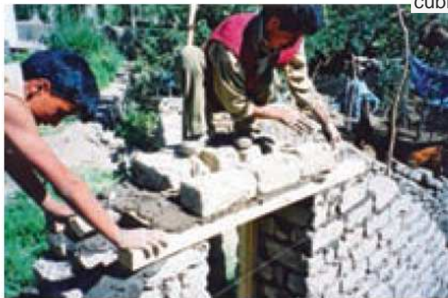
Figura 48: El procedimiento de albañilería para la construcción del muro y apoyar la puerta
