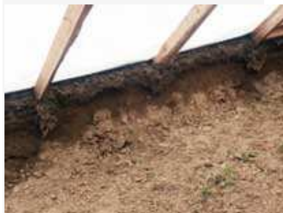
Figura 75. Viguetas equilibradas sobre una capa de tierra que se desmorona ( nivel de tierra exterior) en un invernadero sin cimentación al sur.
